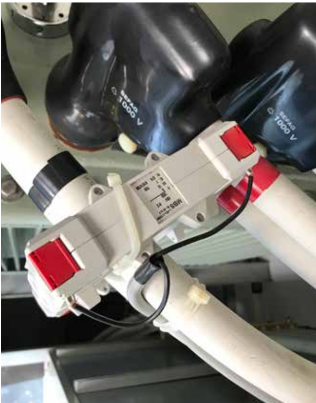
Transformateur de courant: 1000/5A
