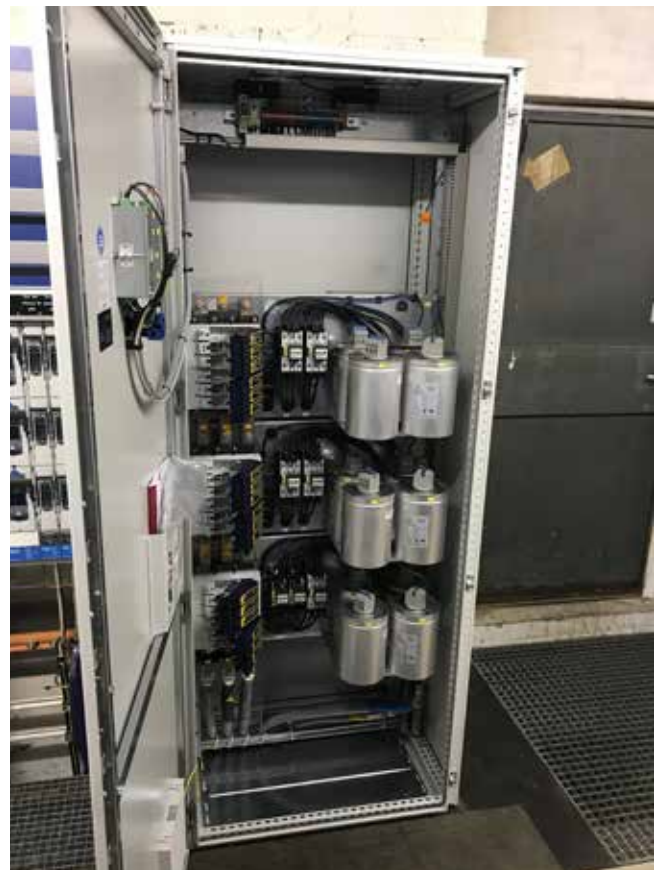
Condensateurs de puissance
